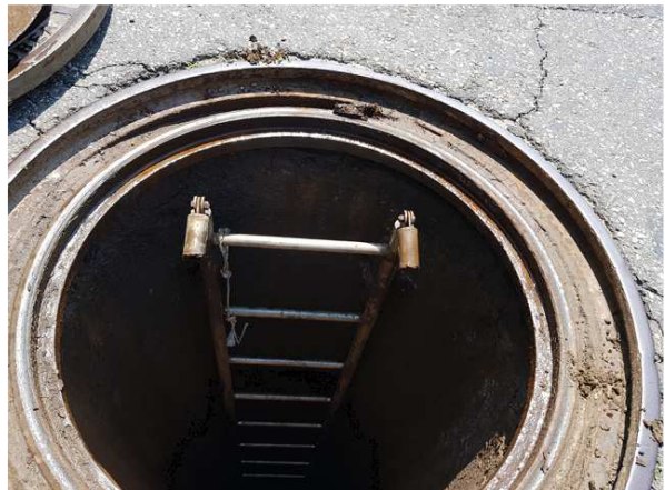
내용 안전손잡이 안전손잡이 파손
